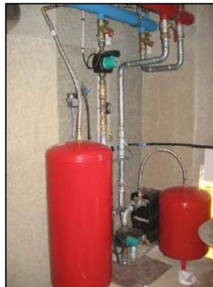
Gestion des réseaux de chaleur
