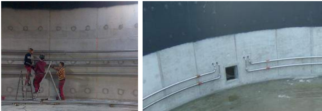
Réseau de chauffage du digesteur et du post-digesteur
